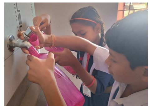
飲料用給水施設
