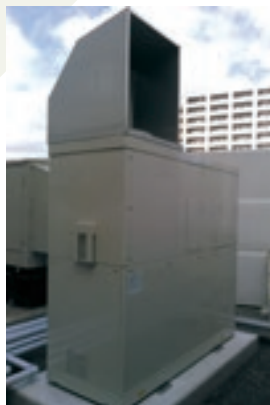
本部に設置されたSVO発電機
