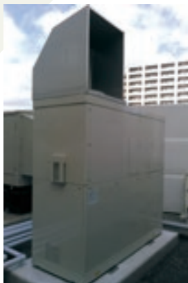
本部に設置されたSVO発電機
