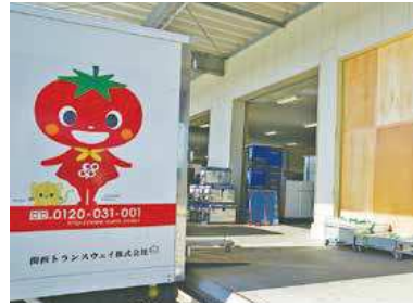
▲ 強風で破損したシャッターを板で補強している共同購入センター
