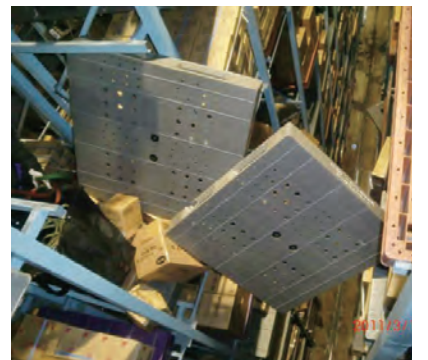
11年3月17日に撮影された、仙台流通センターの自動倉庫の様子。
