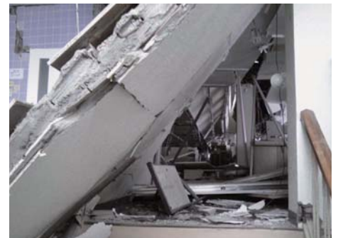
大きな被害を受けたみやぎ生協本部A棟内部の様子。
