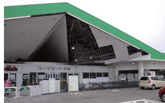
軒下の天井が落下したコープマート保原。コープふくしまで最も大きな被害を受けた店舗のひとつ。
