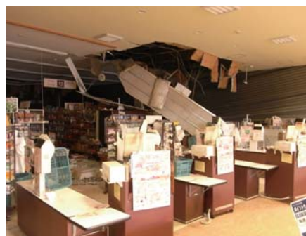
いばらきコープ・水戸店の様子。レジの上の天井が崩れ落ちている。
