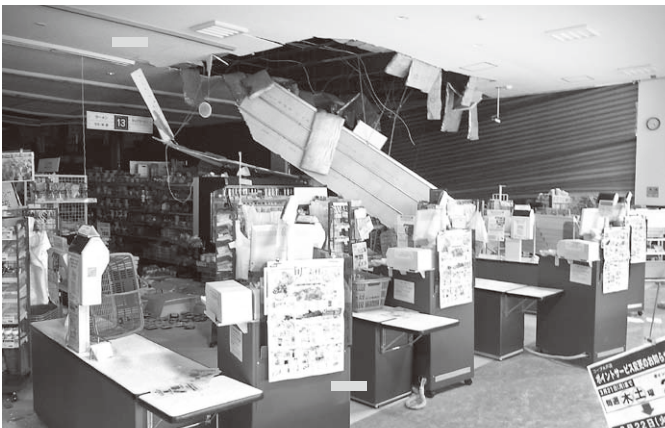
水戸店では天井が崩れ落ちた。
